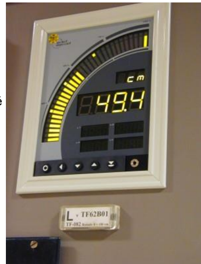
Přístroj na dozorně
